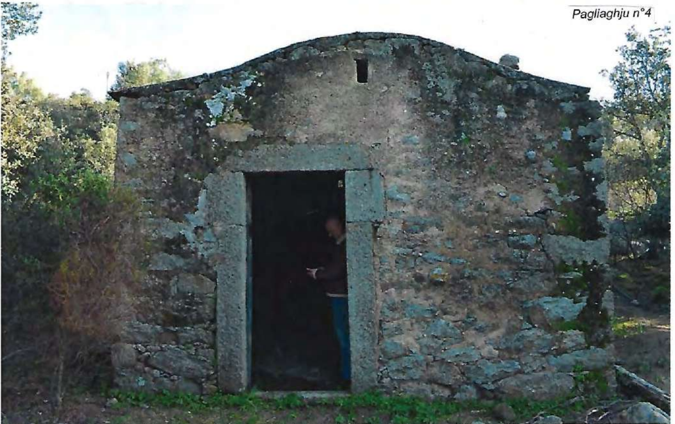
Photos de l'édifice aujourd'hui : la toiture et l'ouverture principale ont été restaurées. La toiture présente un couverture en chapeau de gendarme.
